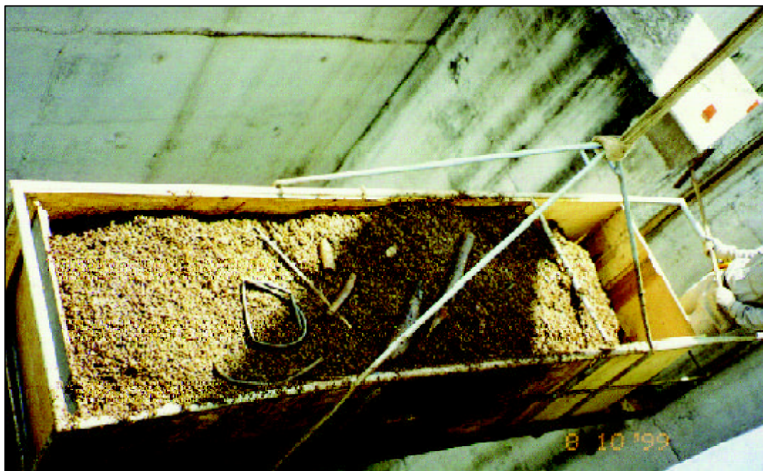
FIGURA 4: contenedor cargado con el mitílido invasor en el momento de ser subido para eliminar los ejemplares acumulados en la unidad 7 de la represa de Yacyretá (octubre 1999).
